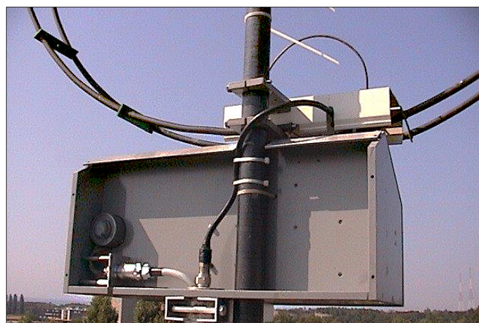
À l'arrière arrivée du coax et du câble de commande
